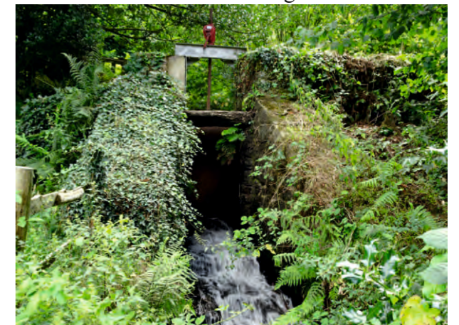
vanne du canal de décharge
